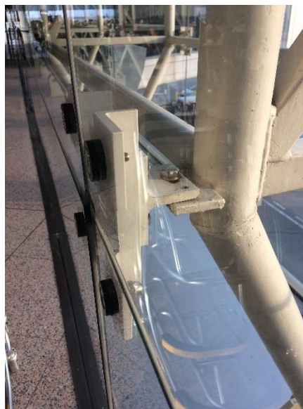
Figura 52 – Sistema de fixação do Aeroporto de Madrid, vista 2.
