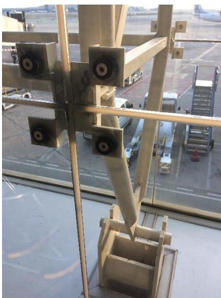
Figura 51 – Sistema de fixação do Aeroporto de Madrid, vista 1.
