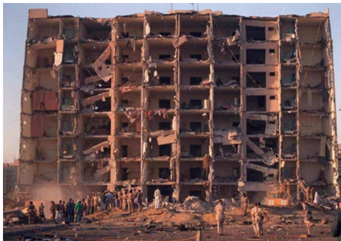
Figura 3 – Vista exterior do colapso das fachadas exteriores das Torres Khobar [10].
